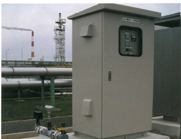
ヒータ制御盤
